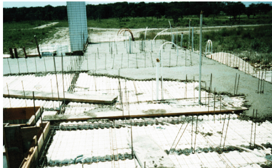
Figura 18 – Betonagem da laje e armadura para a colocação dos painéis do piso seguinte
