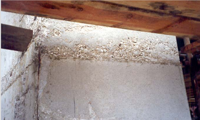
Segregação do betão
