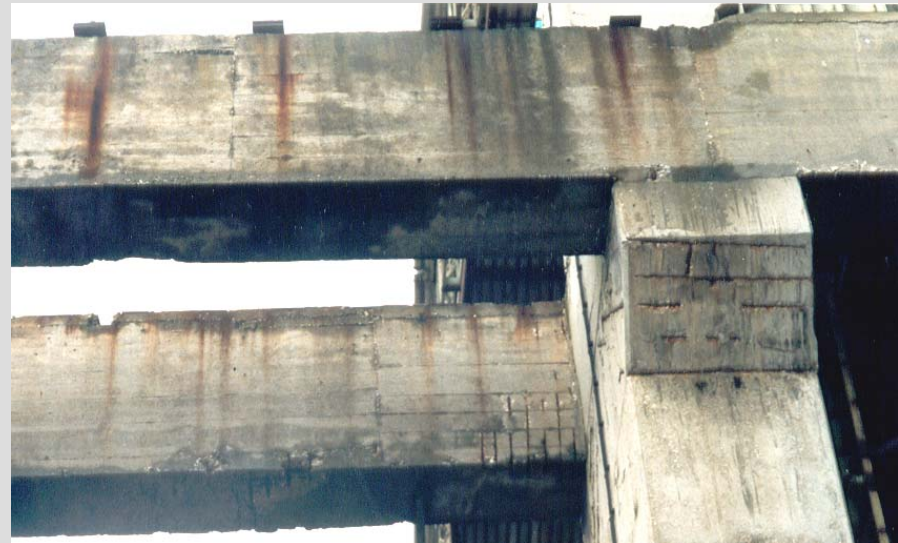
Deficiente colocação dos espaçadores
