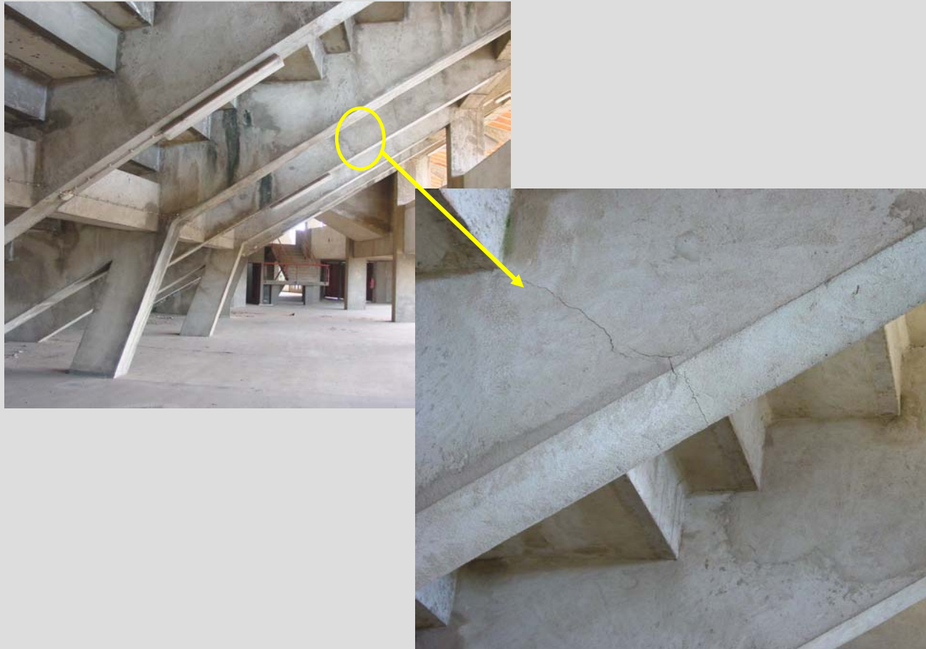
Fendas de flexão numa viga
