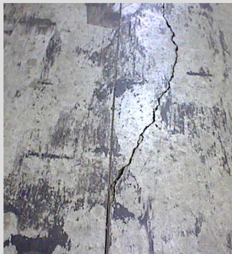
Junta executada demasiado tarde
