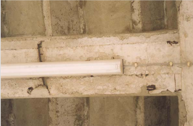
Espaçadores em material inadequado
